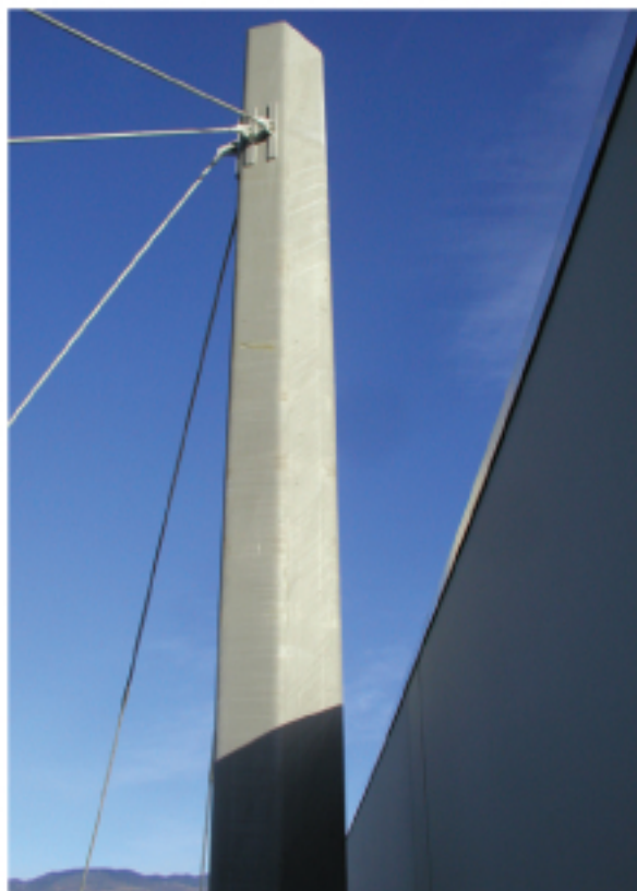
La colonna che sorregge la pensilina di copertura della zona carico-scarico, La Nordica-Extrafiame, Breganze (VI).
